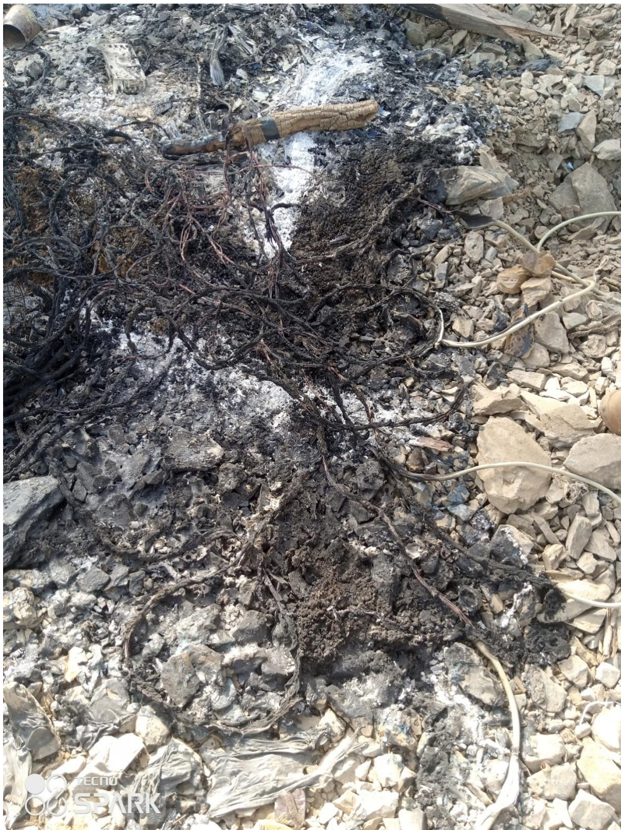
Photo4 : câblage (fil électrique) complètement brulés
