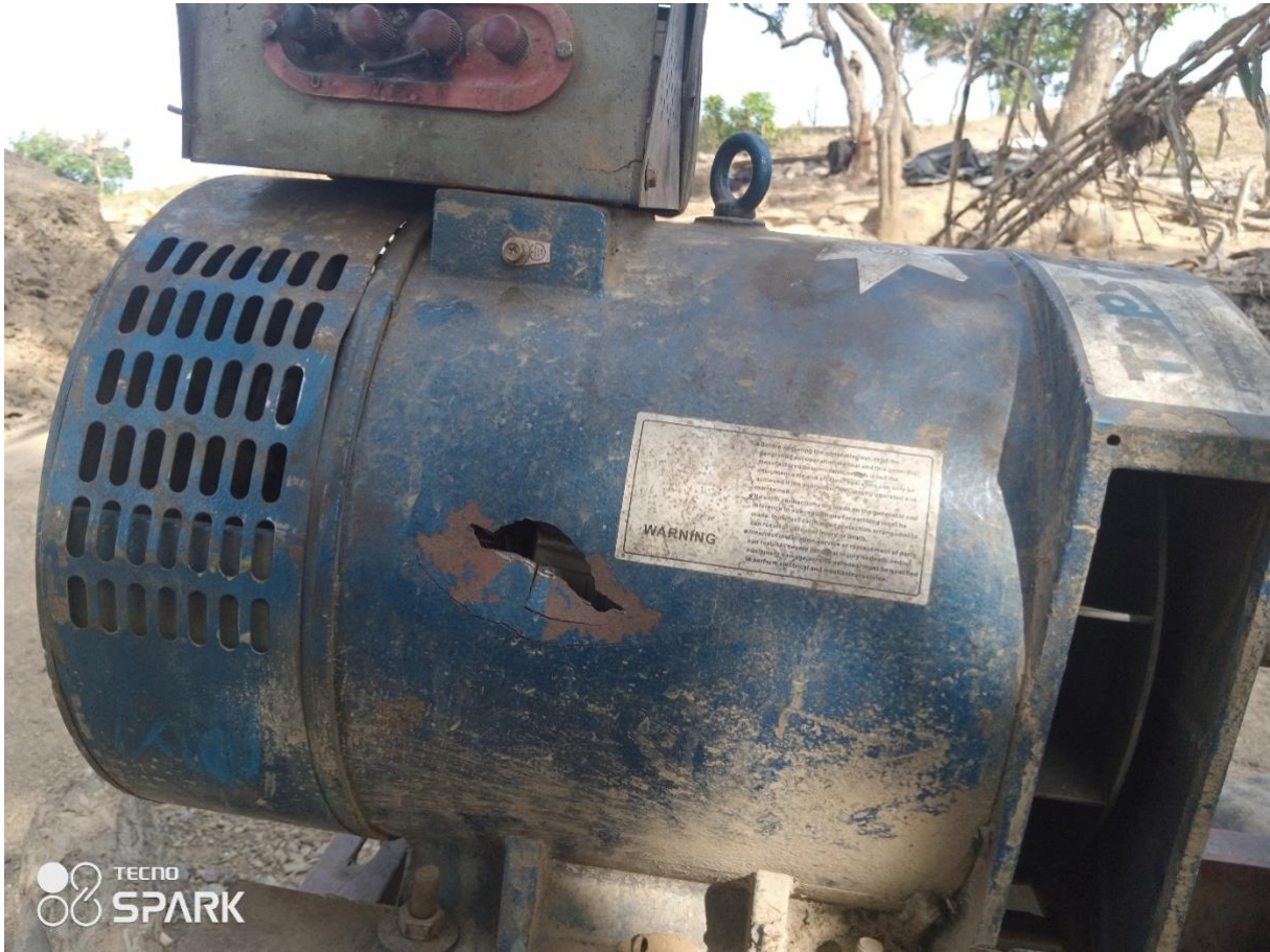
Photo7 et 8 : groupe électrique mis hors d'usage
