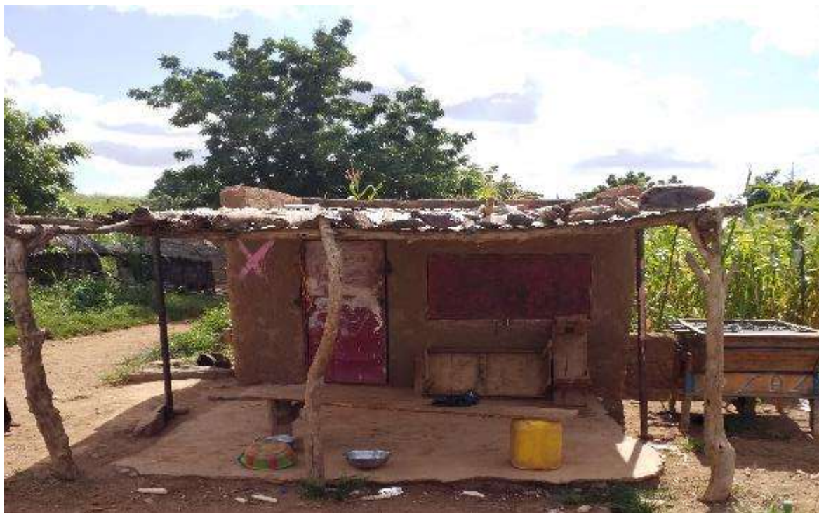
Photo 3 : Maison en banco impactée dans le Village de Bendogo, Commune de Absouya
