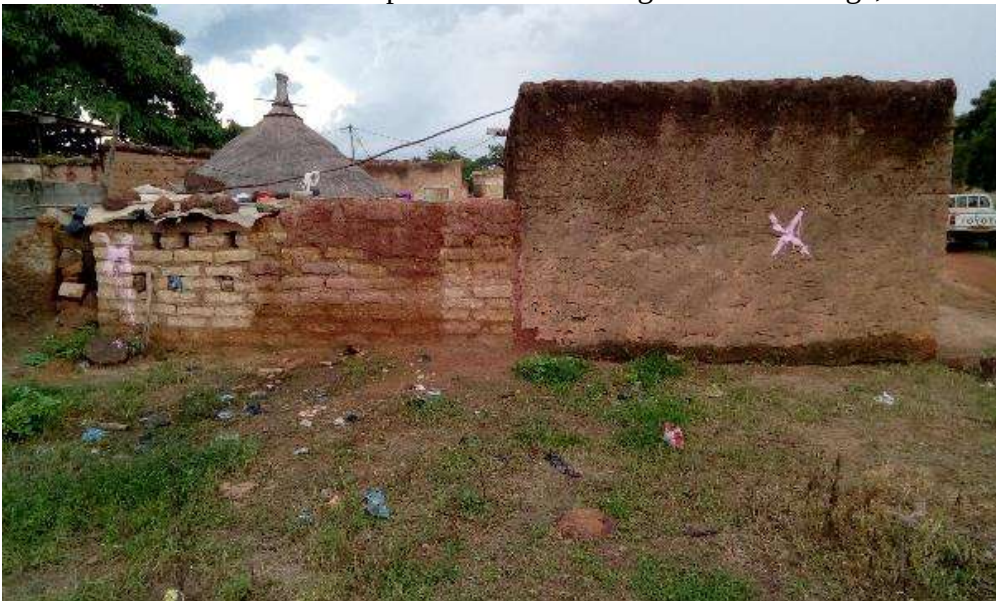
Photo 6 : Maison en banco impactée dans le Village de Nakamtenga, Commune de Nagreongo
